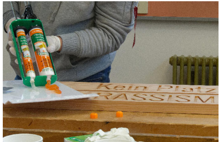
/ ... und anschließend die 2K-Spachtelmasse auf Epoxidharzbasis von Repair Care mithilfe einer Dosierspritze zum Mischen auf eine Unterlage gespritzt.
